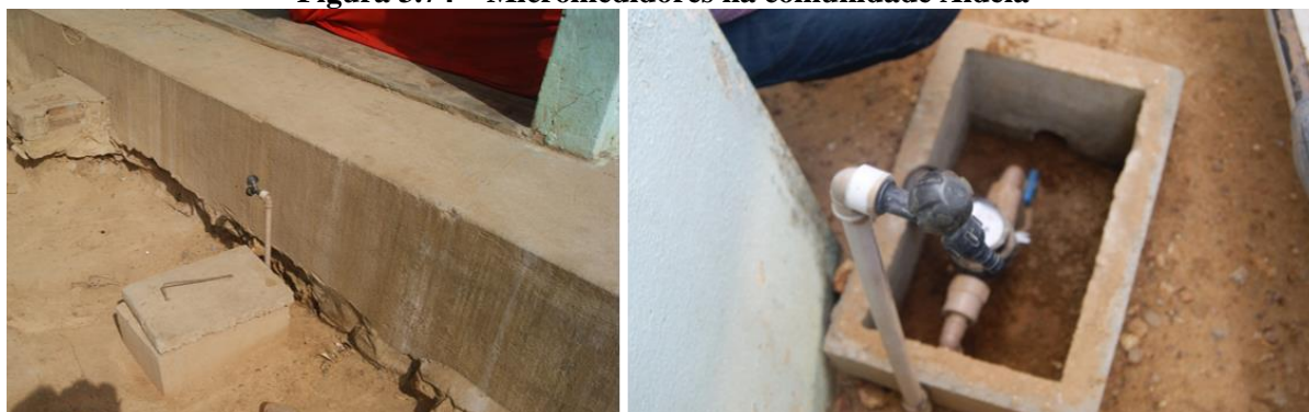
Figura 3.74 – Micromedidores na comunidade Aldeia
