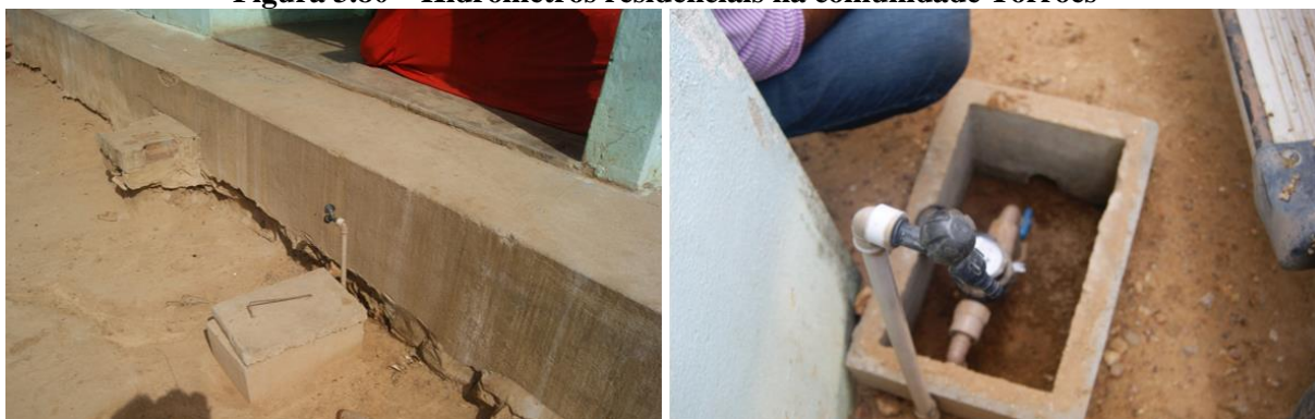
Figura 3.80 – Hidrômetros residenciais na comunidade Torrões
