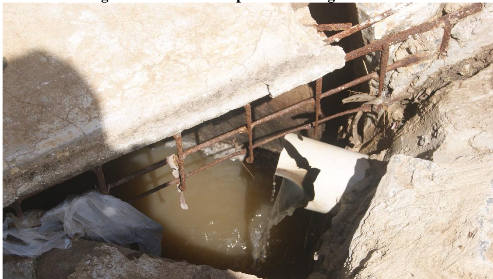
Figura 3.116 – Galeria pluvial com esgoto sanitário
