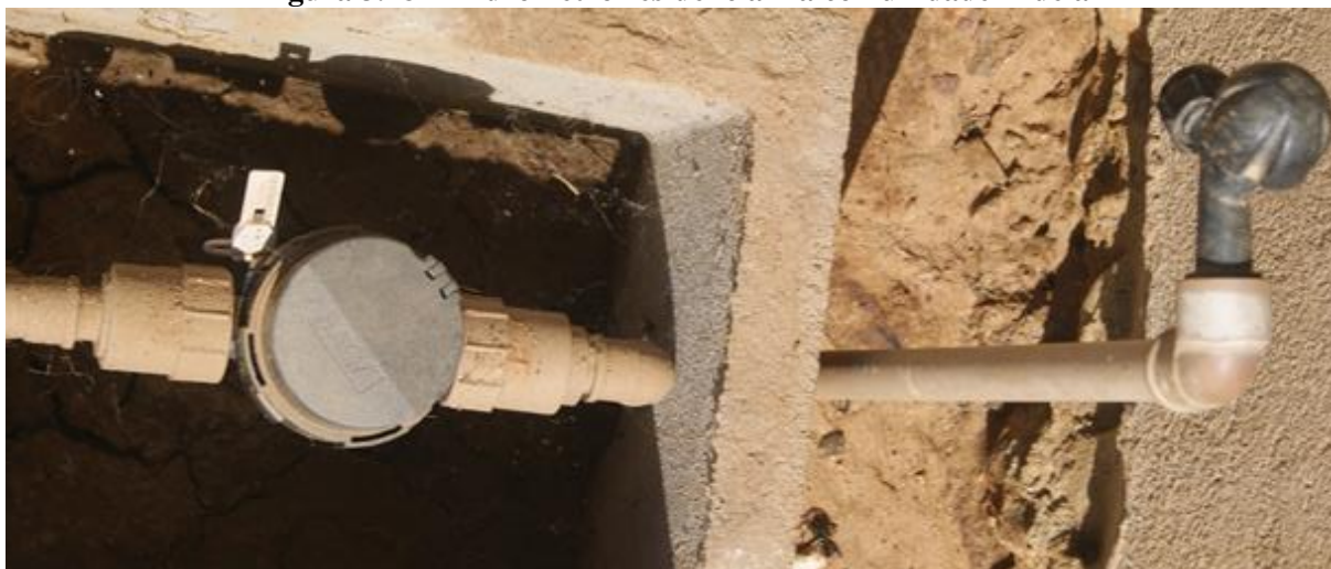
Figura 3.78 – Hidrômetro residencial na comunidade Aldeia
