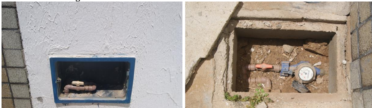
Figura 3.65 – Hidrômetros residenciais do SAA de Livramento
